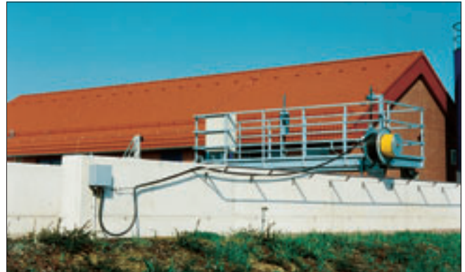
Haupteinspeisung eines Längsräumers auf einem Klärwerk mittels Federleitungstrommel
