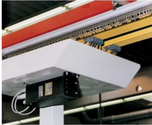
Kompaktschleifleitungen (9-polig) mit digitalem Datenübertragungssystem POWERTRANS® im Lager eines Küchenherstellers
