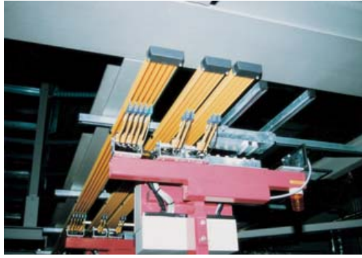
Kompaktschleifleitungen (13-polig) in einem von 33 Paketverteilzentren der Post AG
