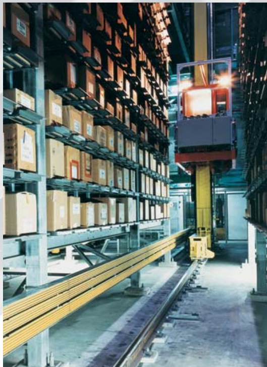
Kompaktschleifleitungen (13-polig) mit Doppelstromabnehmern im Vertriebszentrum eines Versandhauses
